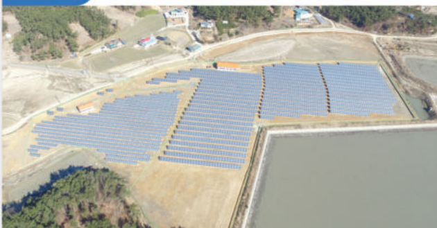
2,100kW 충남 태안군 소원면 송현리 618-4번지
